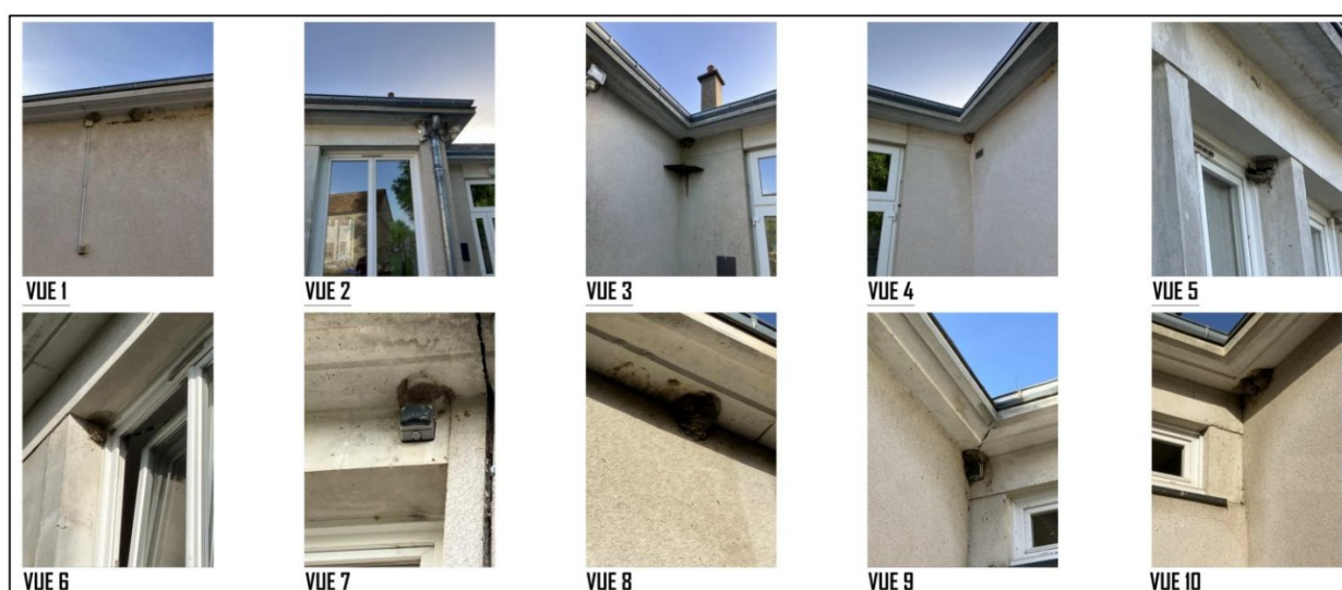
Localisation des nids d'hirondelles des fenêtres sous les linteaux de menuiseries et sur les débords de toiture du bâtiment B
